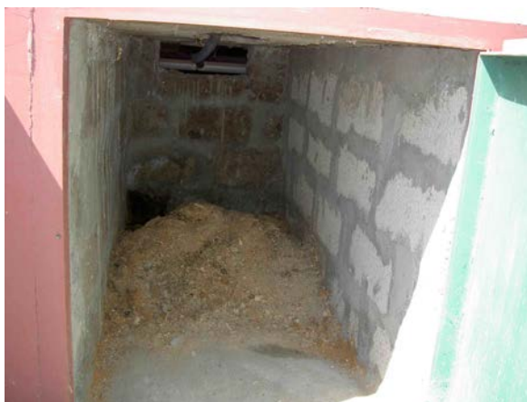
Школски СТПУ: комора за сакупљање, складиштење и третман фекалних материја
