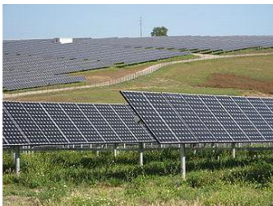
Slika 2. Solarna elektrana u Portugalu (11MW)
