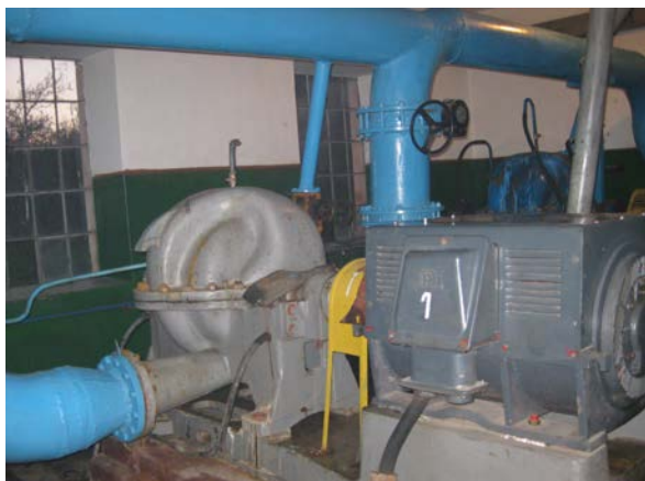
Машинска просторија водоснабдевача
