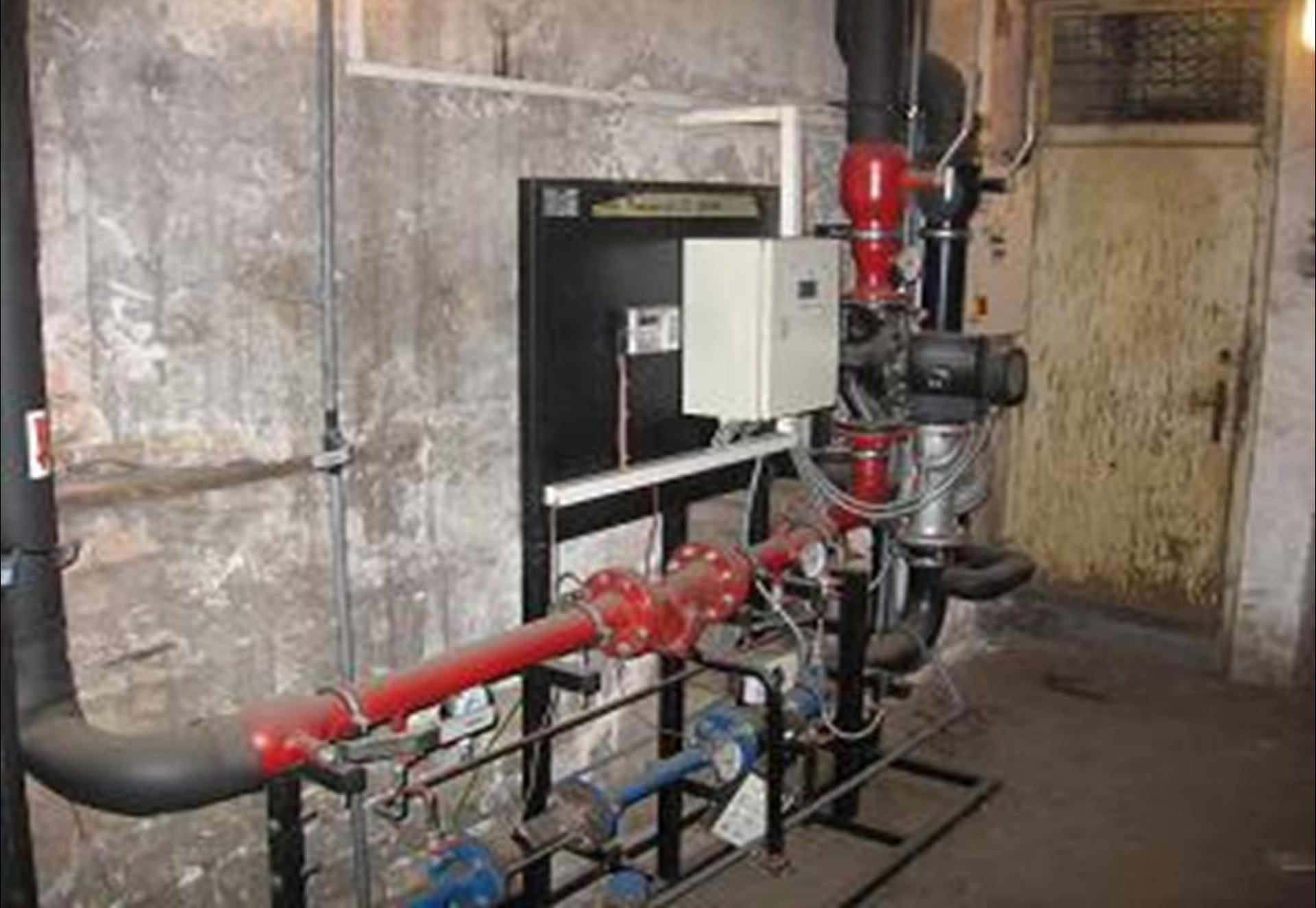
Примена топлотне пумпе
